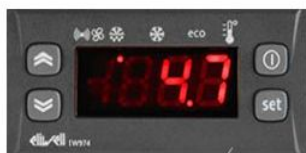
Рис. 6 Панель управления и контроля
